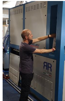
Instalace vodíkového generátoru
